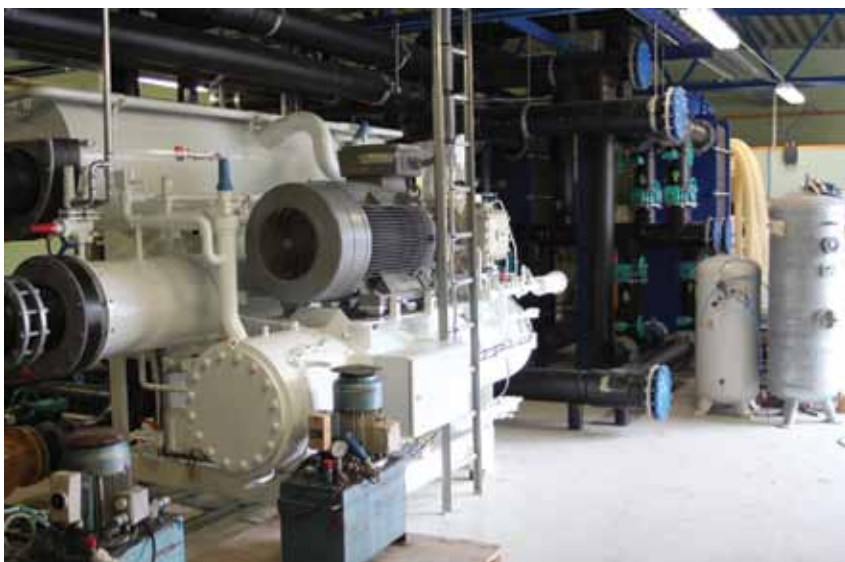
Fra maskinrommet: Mye automatikk og styring. En varmepumpe bruker kjølevann fra metanol-fabrikken på Tjeldbergodden for å gi vannet i settefiskanlegget rett temperatur. Foto: Oddvar Lind
