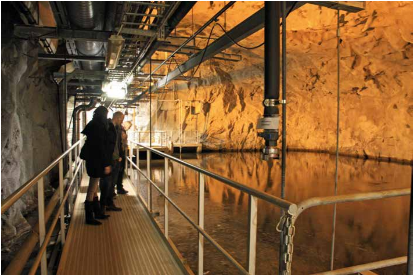
Fra Bekkelaget renseanlegg i Oslo. Foto: Audun Sørsdal, Oslo kommune
