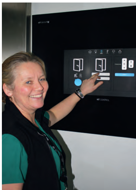
Moderne bygg: Her sjekker Sigrid Lykkjen kontrollpanelet for romfunksjoner. Foto: Steinar Tessem
